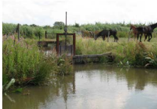
Neuenfelder Wettern mit Regelbauwerk
